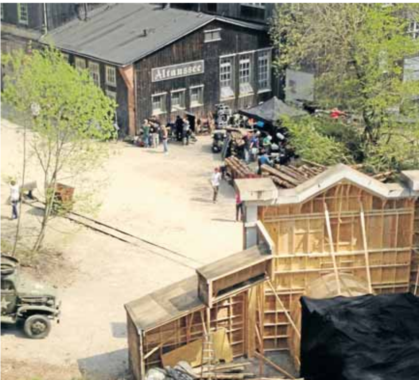
Alt und neu: Einerseits wurde eine aufwendige Kulisse gebaut, andererseits bedienen sich die Filmemacher an den bestehenden Gebäuden, um Szenen zu drehen, die im späteren Film in Altaussee in Österreich spielen. Archivfoto: Bornemann
